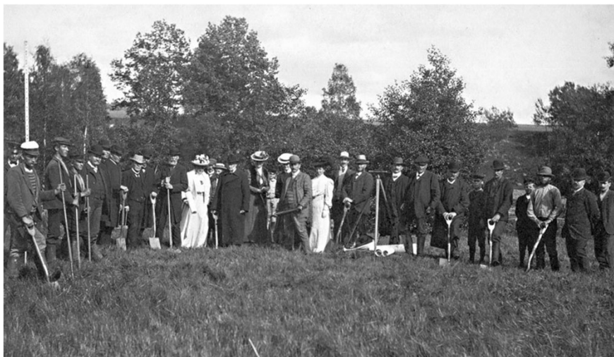
Friherre Axel Hermelin, som ses till vänster om den vitklädda damen, tar det första spadtaget vid Svartåregleringen den 22 augusti 1908. Till vänster om honom ses kammarjunkare Henrik Stierngranat, som var en av ledarna för projektet.
