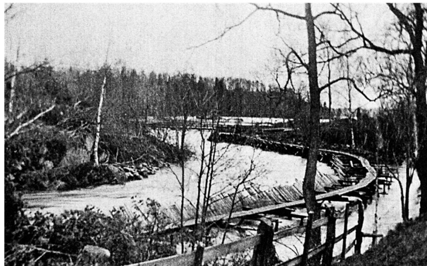
Svartåregleringsföretaget omfattade en sträcka av 32 km. Bilden visar grävningsarbetet öster om Stora Mölarps gård.
