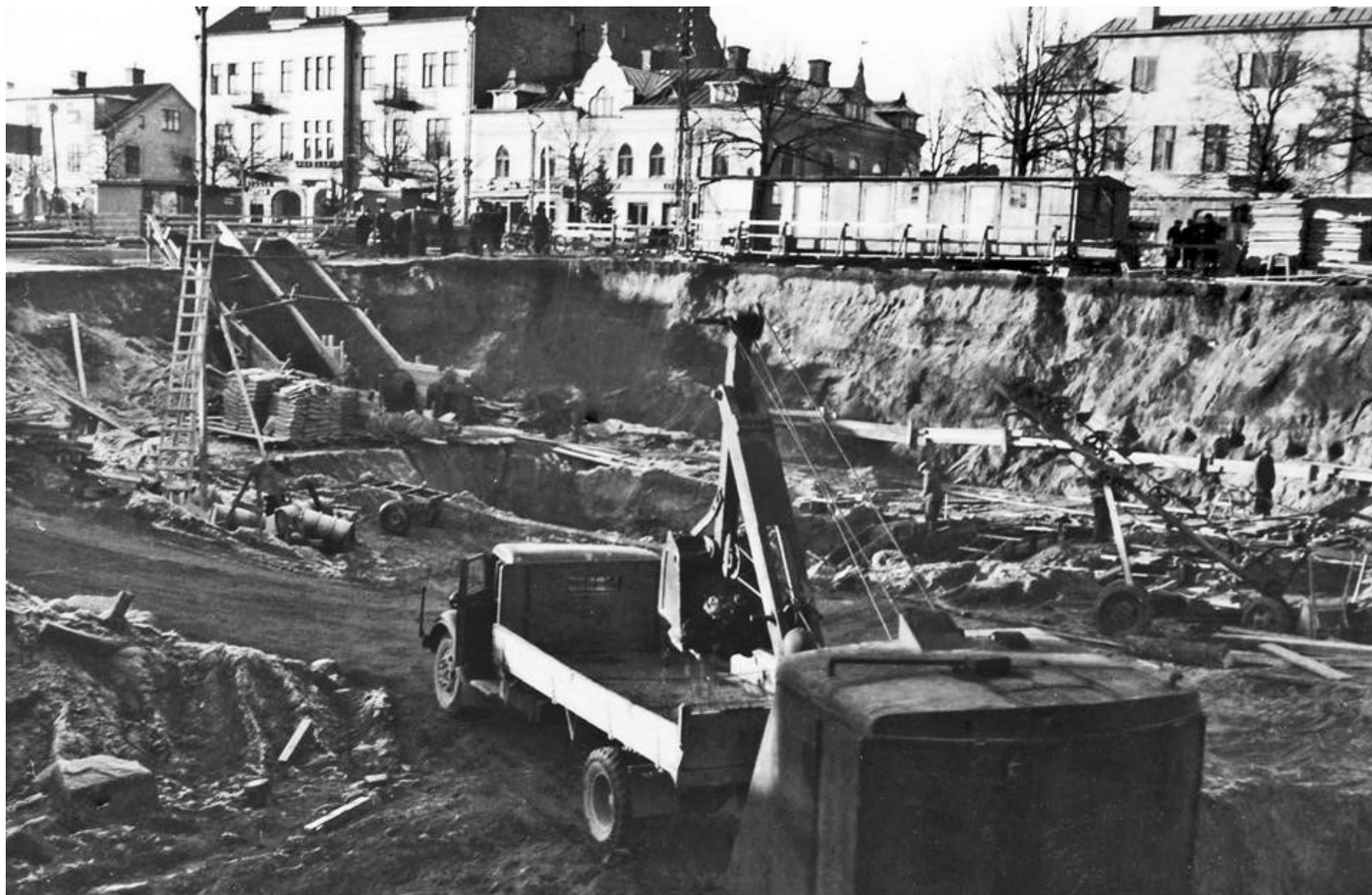
När Stadshotellet byggdes, grävdes c:a 20 000 m 3 schaktmassor bort med hjälp av 5000 lastbilstransporter. Arbetet utfördes av Dahlstedts åkeri, 1953-54. Schaktmassorna transporterades för utfyllnad av Stadshusparken
